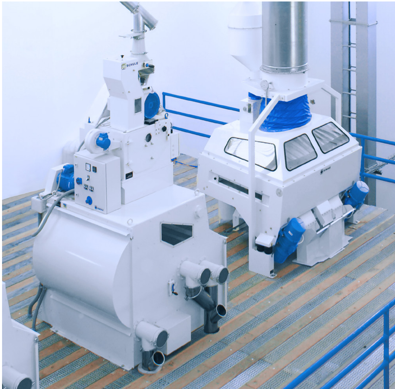
↑ Einblick in eine Reisanlage von SCHULE
